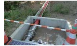
貯水池からの送水ライン
