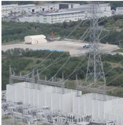
開閉所からのびる送電線と送電鉄塔
