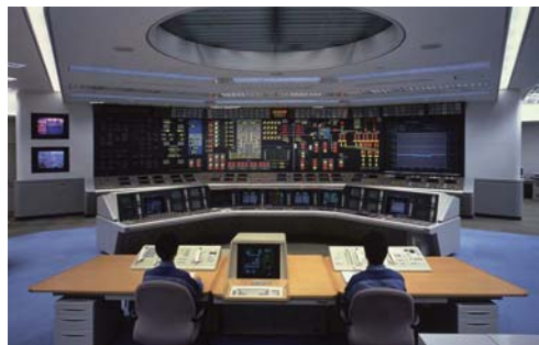
中央制御室(6,7号機のタイプ)
