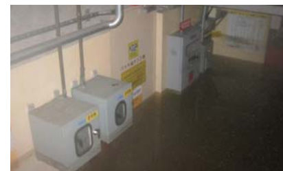
福島第一原子力発電所2号機・水没した電源室
