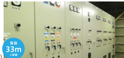
高台電源設備(配電盤)
