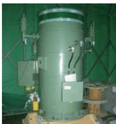
海水ポンプ 予備モーター
