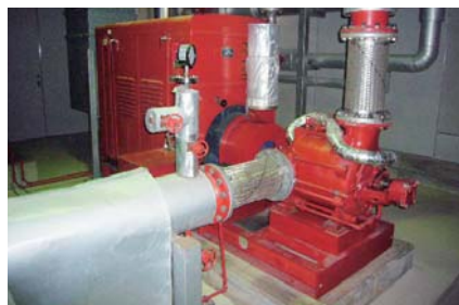
ディーゼル駆動消火ポンプ (写真は現在設置されているディーゼル駆動消火ポンプのもの)
