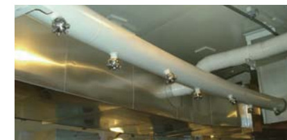
格納容器スプレィ吹き出し口
