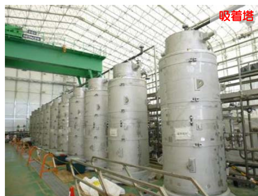
高性能多核種除去設備設置状況
