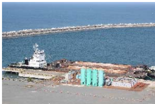
被覆材製造プラント（全景）
