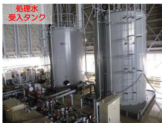
増設多核種除去設備設置状況
