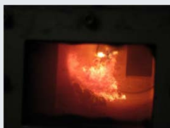
焼却炉内の燃焼状況
