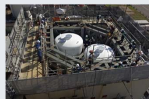
7号機 地上式フィルタベント設備 (よう素フィルタ設置状況)
