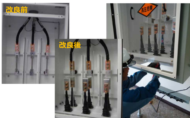
電源車からの電源ケーブル接続端子の改良（福島第二）
