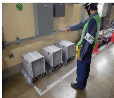
管理区域内への高性能リチウム蓄電池の配備（柏崎刈羽）
