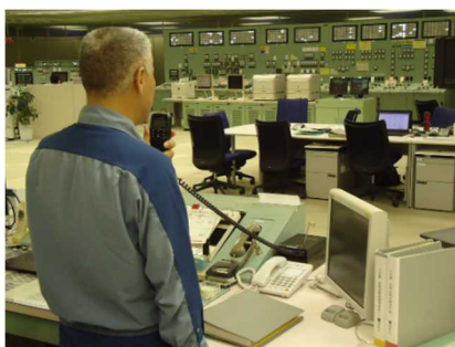
中央制御室と緊急時対策室を結ぶ無線通信設備の導入（福島第二）
