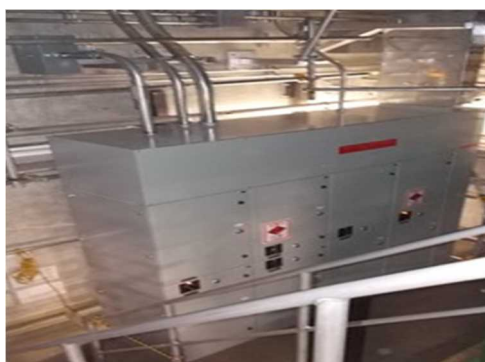
直流 125V 高圧代替注水系ポンプ用配電盤 (7号機)
