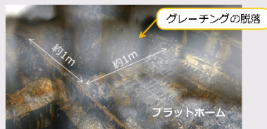
2号機原子炉格納容器内部調査画像 (ペDESTAL内のグレーチング脱落状況)
