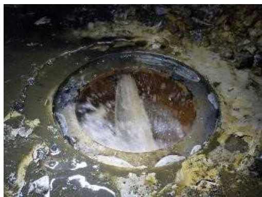
流入が確認された床ファンネル
