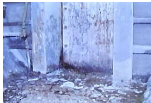
内扉前の堆積物
