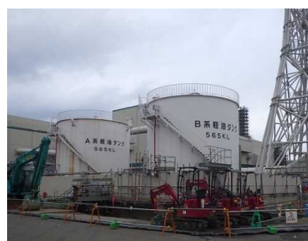
6号機軽油タンク
