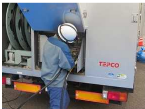
電源車操作訓練
